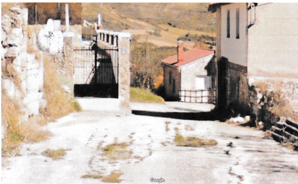
Estado calle Nueva “camino de Santiago”, al menos desde octubre 2013.
